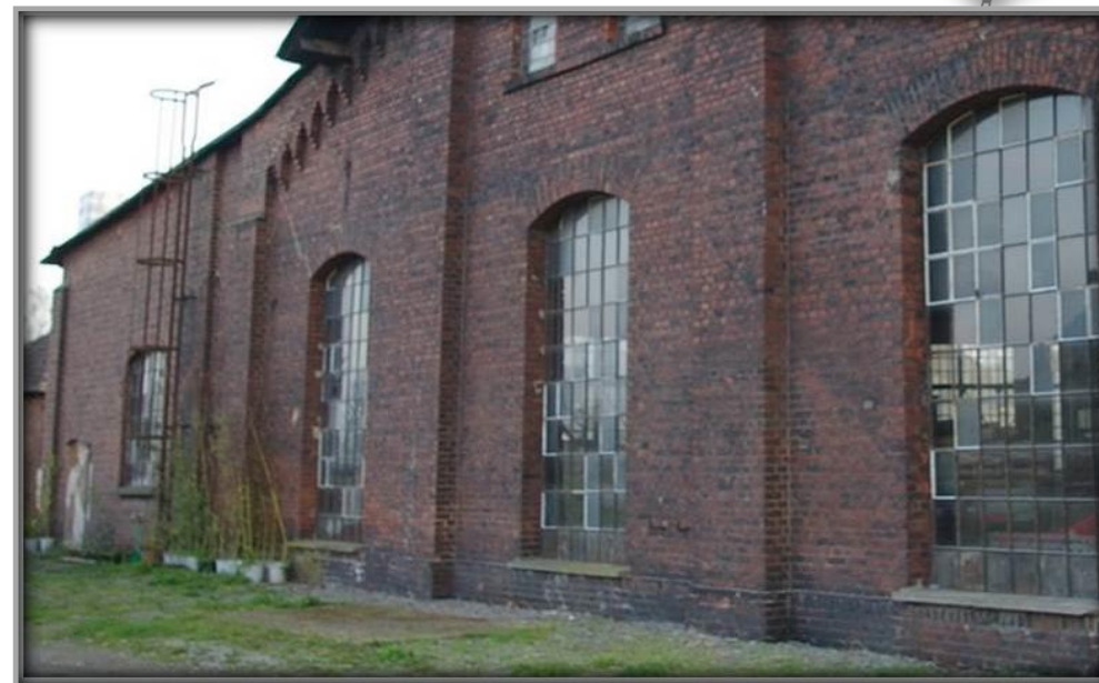
Das Buschwerk wurde beseitigt und die Fenster stilgerecht ersetzt. Erste Vermietungserfolge beleben inzwischen die alte Lokhalle.
